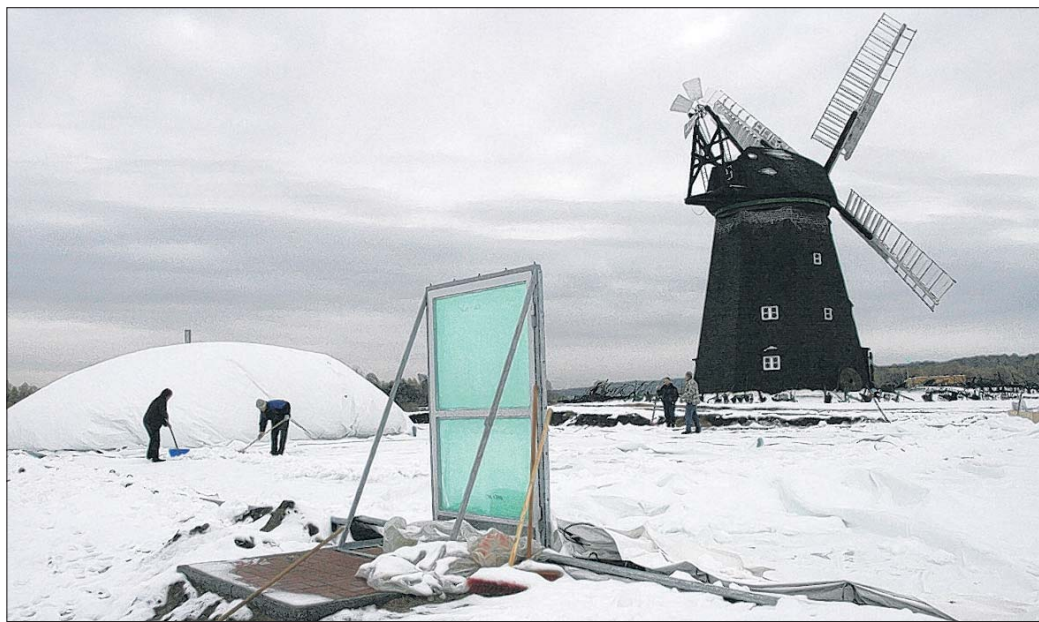
Neben der alten Windmühle entsteht gerade die neue Traglufthalle. Im Vordergrund steht eine der künftigen Fluchttüren, dahinter „wächst“ gerade die Folie zur späteren Traglufthalle heran. Foto: B. Wüstemann
